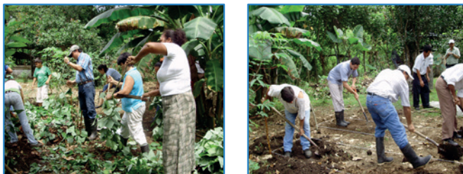
Figura 14. Recolección de material y echura de la zanja de 30 cms de profundidad.
