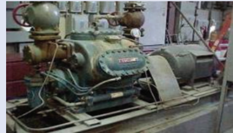
Fig 35. Compresor abierto para compresión de amoniaco
