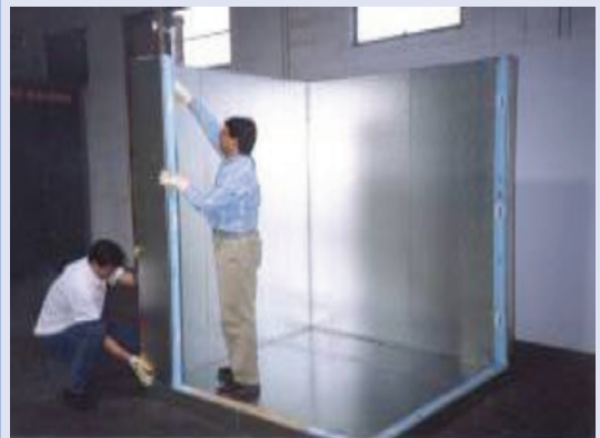
Fig 20. Aislamiento en los cuartos fríos
