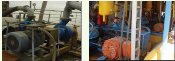
Fig 1. Motores eléctricos conectados a un compresor de refrigeración y a bombas centrífugas
