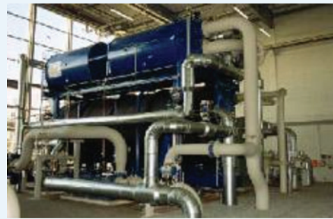
Fig 26. Chiller de absorción
